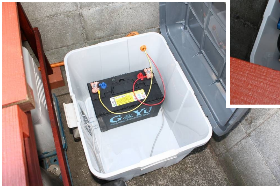
井戸ポンプの奥に設置した蓄電池
